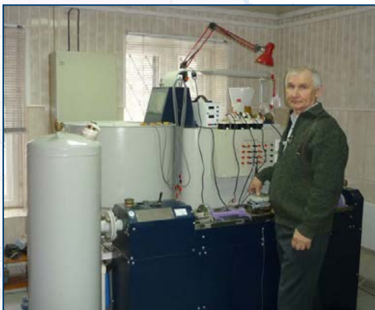
Поверка ультразвукового расходомера на установке УПСЖ 30.
