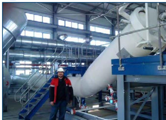
Установка поверочная трубопоршневая двунаправленная ТПУ1900 Варандейского терминала.
