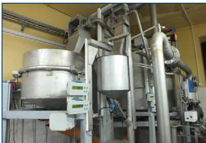
Установка для поверки счетчиков и расходомеров.
