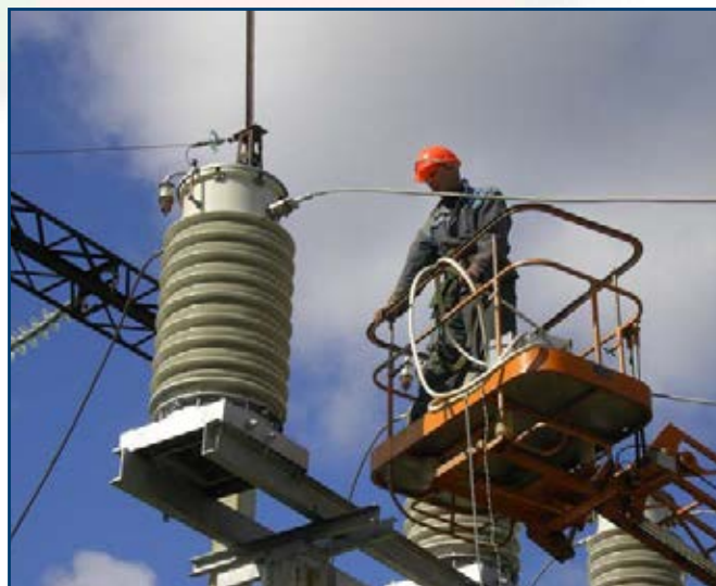
Поверка высоковольтных трансформаторов тока на месте установки.
